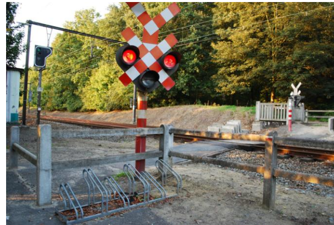
Figure 12 : emplacements de stationnement pour les vélos à la gare de Florival (JNC AWP)
